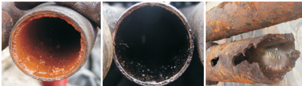
图 2 单元注气三采井油管的结垢腐蚀
